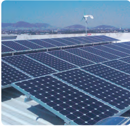
Planta de Energía Solar
