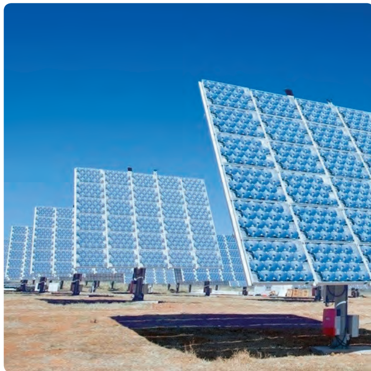
Planta de energía Solar - Calama Solar I / foto:Eco Actualidad
